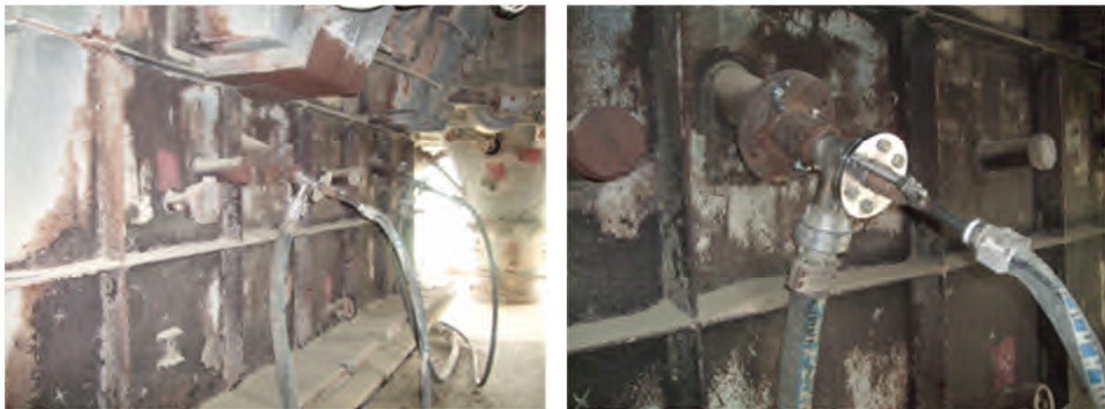
Bild 3-6 SNCR-Anlage auf Bühne 1,5
