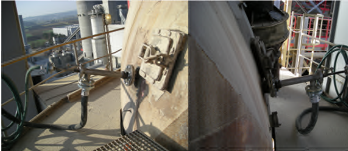
Bild 3-7 SNCR-Anlage auf Bühne 3
